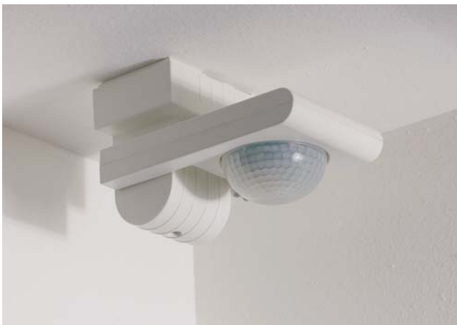
Детектор смонтирован на потолок
