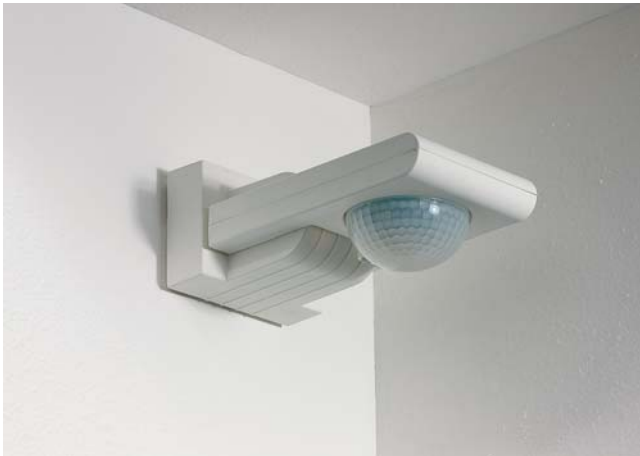
Детектор смонтирован на стену
